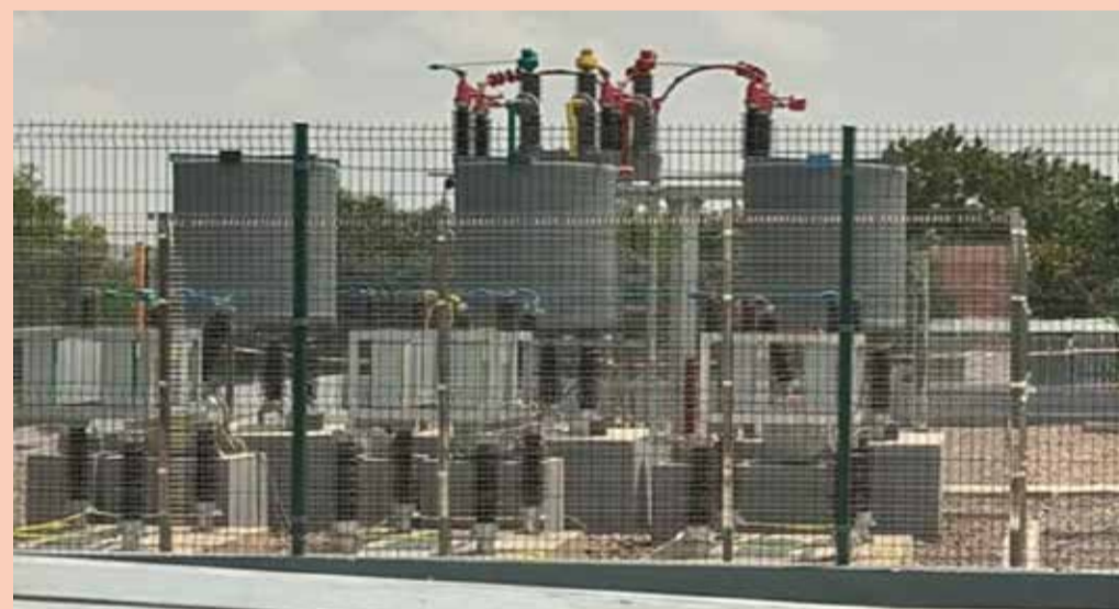
Sous-station de Bipemba à Mbuji-Mayi qui recevra l'électricité de Tubitubidi de la SACIM. DR.
